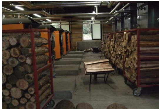
ボイラー室内部（GASIFIER 5基）
